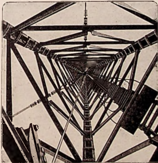
167. Blick in das Innere eines Antennen-Großmastes
