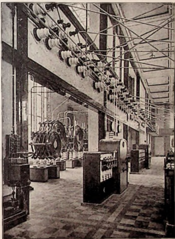
154. Schalttafel und Antennenverlängerungsspulen im Nauener Sendersaal. Davor die alten Tastrelais
